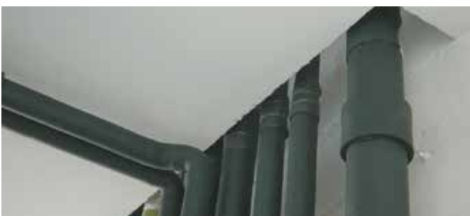
Nichtbrennbare Rohre mit brennbarer Isolierung.
