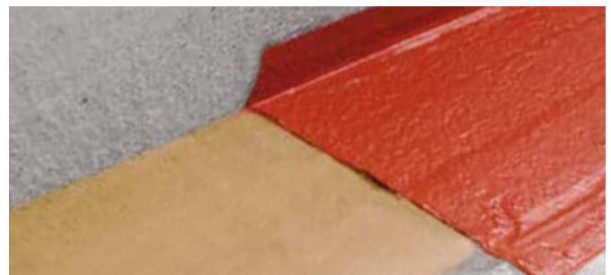
④ Fuge Wand zum Boden.
