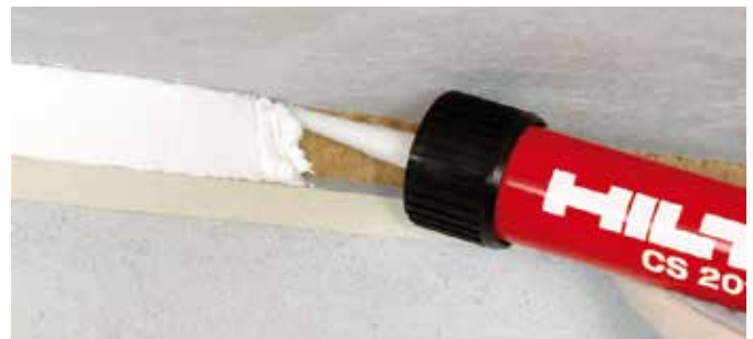
③ Fuge Wand zur Decke.
